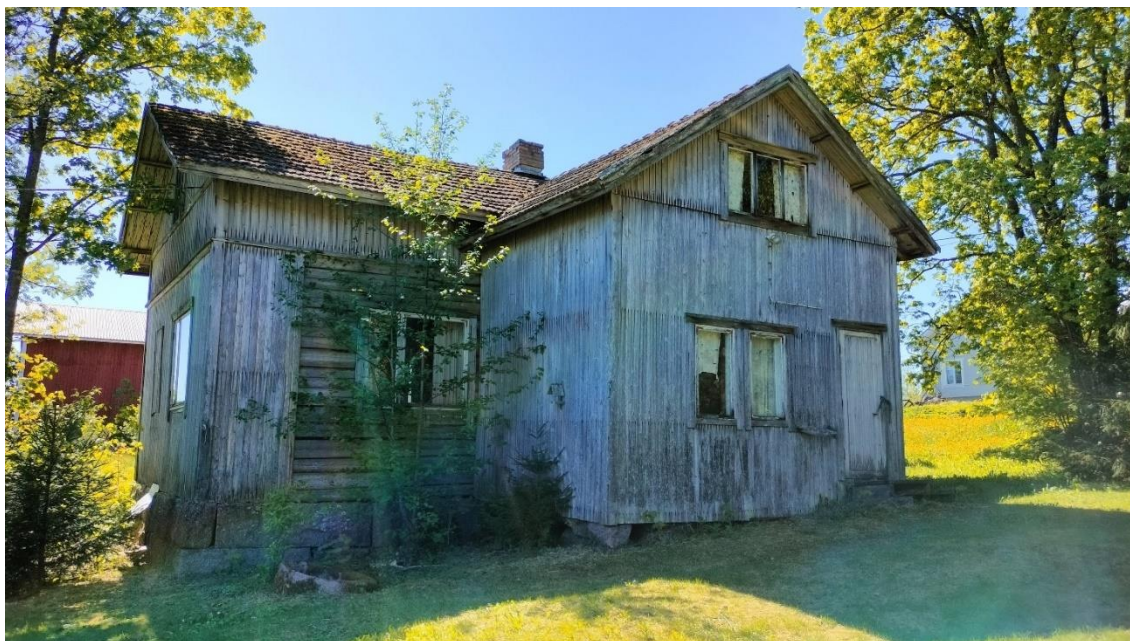
Kuva 36 Rantasalmen asuinrakennus (tilan vanha päärakennus on jo purettu) on vuodelta 1923. Tyhjillään oleva rakennus on heikossa kunnossa.
