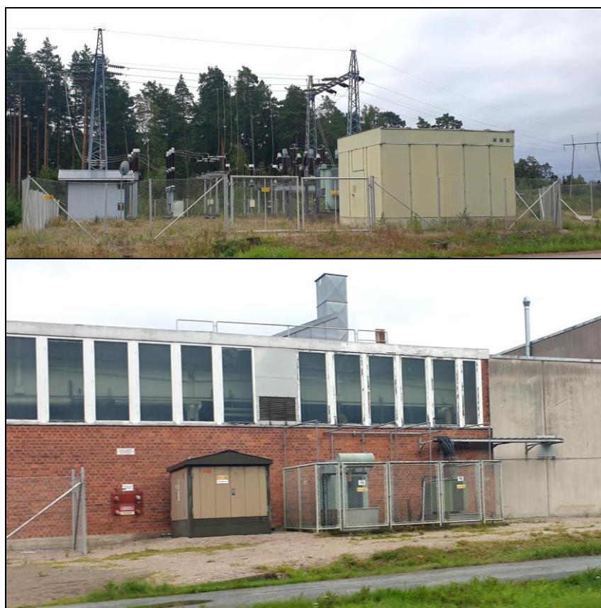
Kuva 15. Sähkökeskus Kauttuan pohjavesialueella (Ylempi) ja Amcorin kiinteistömuuntamot (Alempi).
